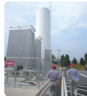
ブリヂストン 磐田工場の天然ガスタンク
