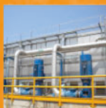
高効率クーリングタワー
