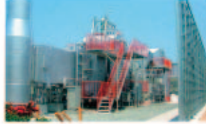
コ・ジェネレーションシステム 発電時の廃熱を有効に使うシステムを導入しています。
