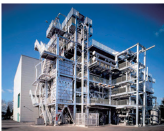
栃木工場焼却発電施設
