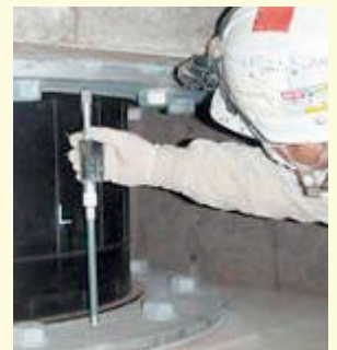
免震ゴム設置後も定期点検で安全・安心を確保
