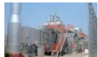
防府工場コージェネレーションシステム
