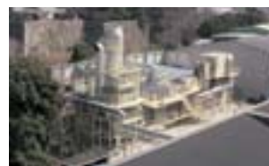
久留米工場コージェネレーションシステム
