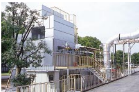
東京工場 脱臭装置
