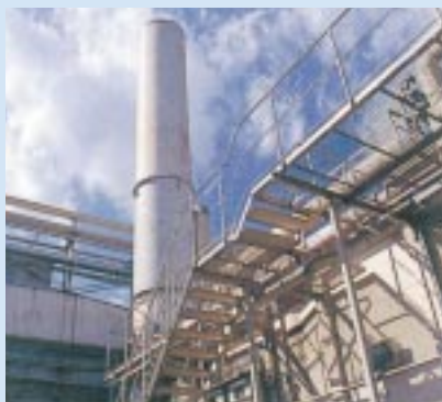
東京工場 コージェネレーション
