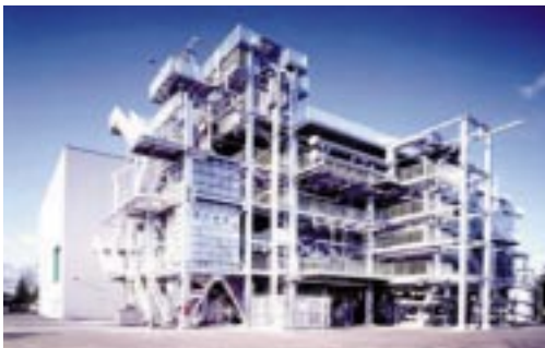
栃木工場 焼却発電設備
